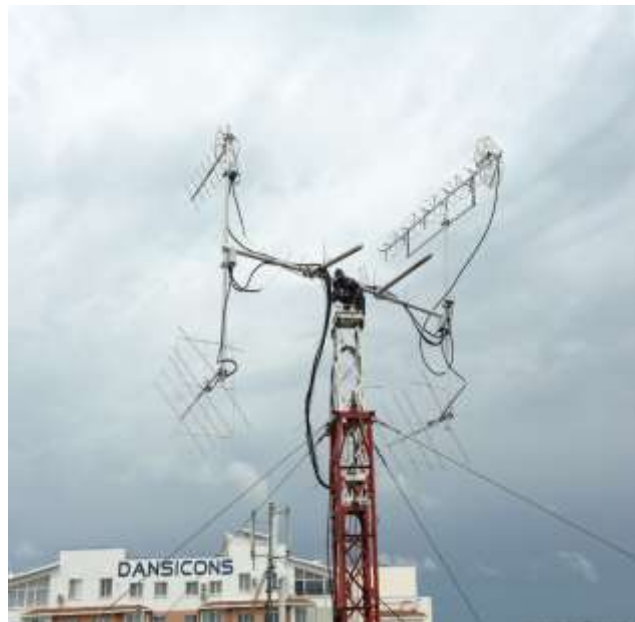
Fig. 2. Structura stației telemetrice de comunicații satelitare și clusterul ei de antene.
