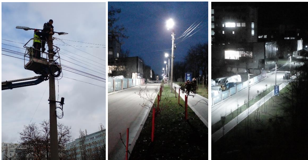
Figura A7.7. Sistemul nou de iluminat stradal din campusul Râșcani al UTM
